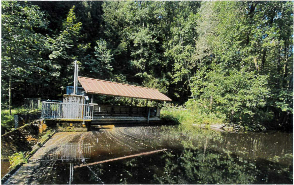
Einlaufbauwerk inkl. Stauklappe, Grundschild und Querrechenanlage (Oberwasser)
